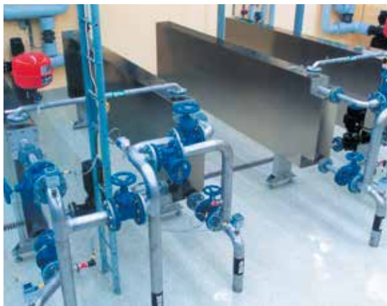
Två värmeväxlarenheter slam/slam installerade på Vimmerby reningsverk.
