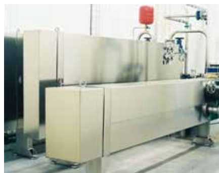
Läckeby Products värmeväxlare slam/vatten och värmeväxlarenhet slam/slam installerade i Älmhult.
